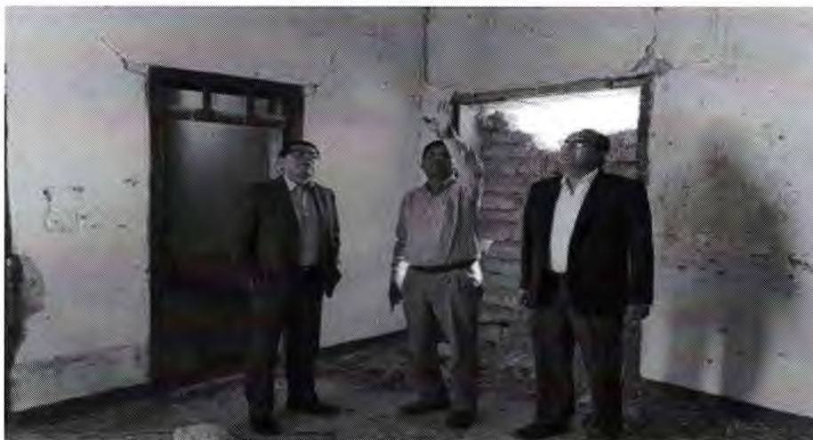
Estado que se encuentra la fachada de la casa José Inclán.
